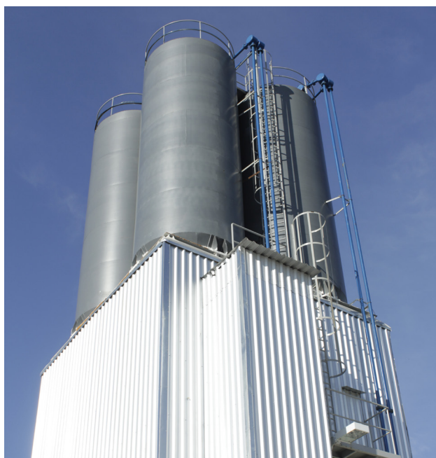
The new plant of Sika in Asunción.
